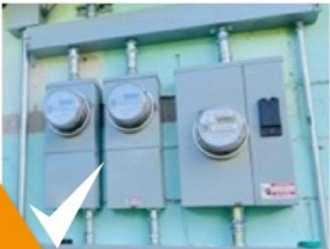
Cambio de acometida principal
